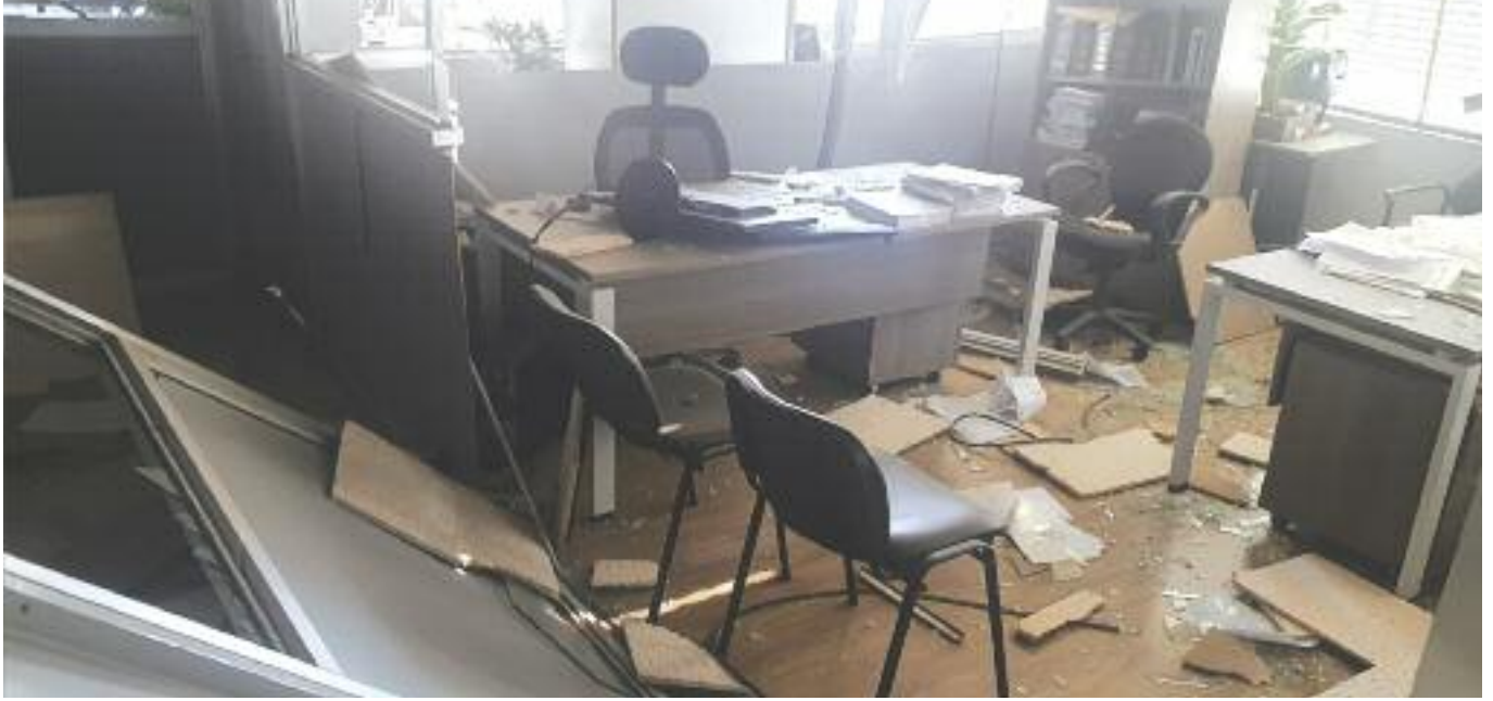
من اضرار مبنى بشاره الخوري
